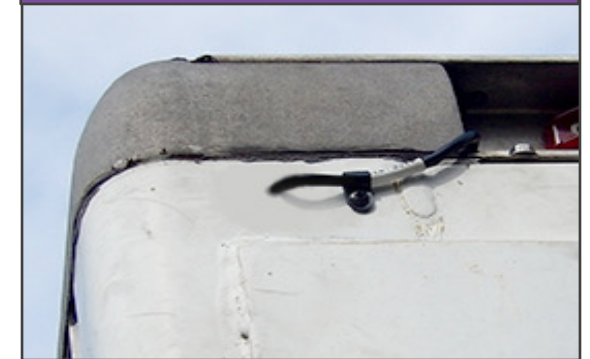
BAD - GROMMET NOT USED
